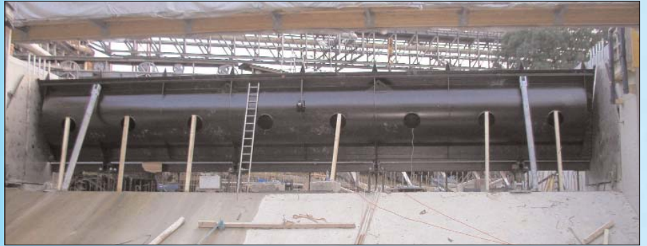
19,5 Meter misst die neue Wehrklappe für das KW Lenzing, die von Gugler Hydro Energy geliefert wurde. Sie wurde mit einem 400 Tonnen-Kran versetzt. Kein leichtes Unterfangen. Foto: GHE
