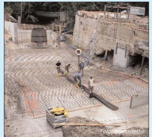
Sohle Einlaufkammer beim KW Pettighofen: Der Erhalt des alten Teilkraftwerks lüftet Geheimnisse der Krafthausgründungstechnik vor 80 Jahren. Foto: Brandstetter
