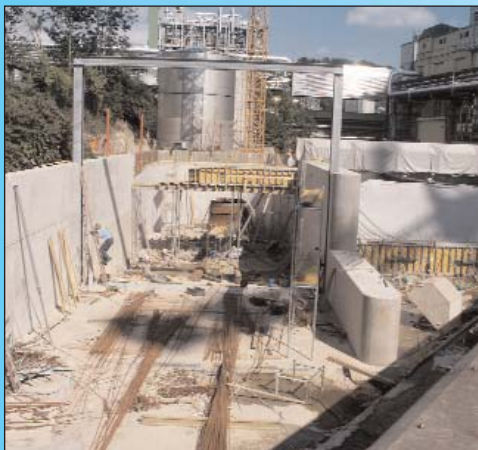
KW Lenzing, das Kraftwerk am Werksareal der Lenzing AG kurz vor der Maschinenmontage. Im Sommer wurde es sechsmal überflutet. Foto: Brandstetter
