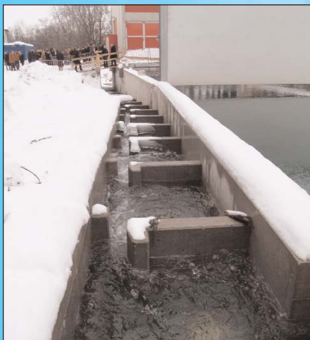
Auch für die Fische eine deutliche Verbesserung: Fischpass in Vertical-Slot-Bauweise Foto: ZeK
